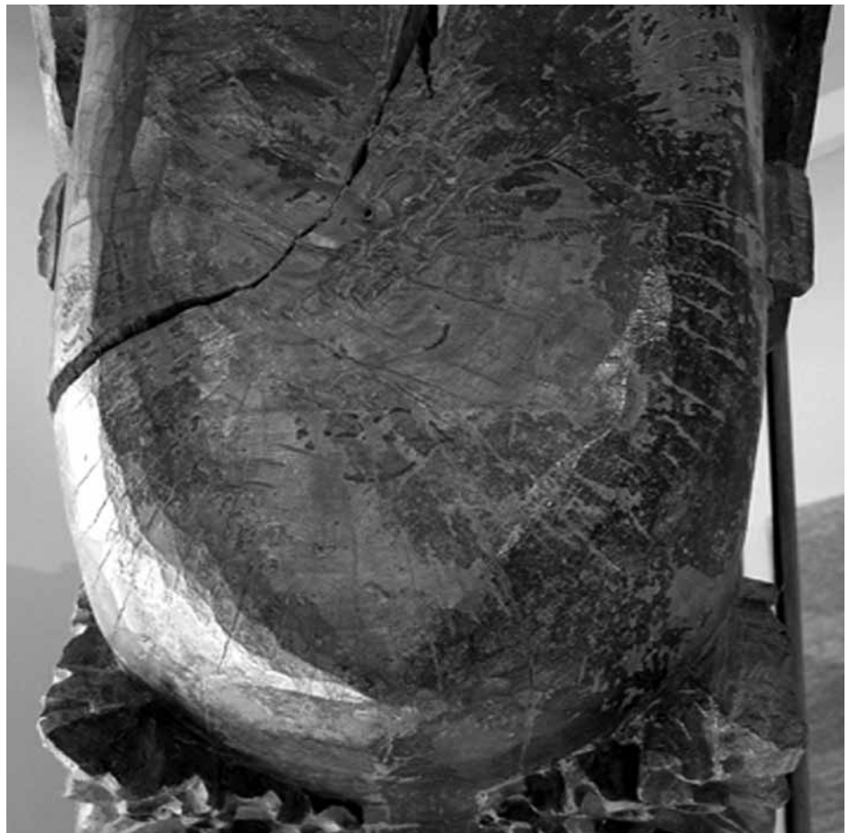
Lámina 3. Detalle de la ménsula 2252 antes de la restauración.
