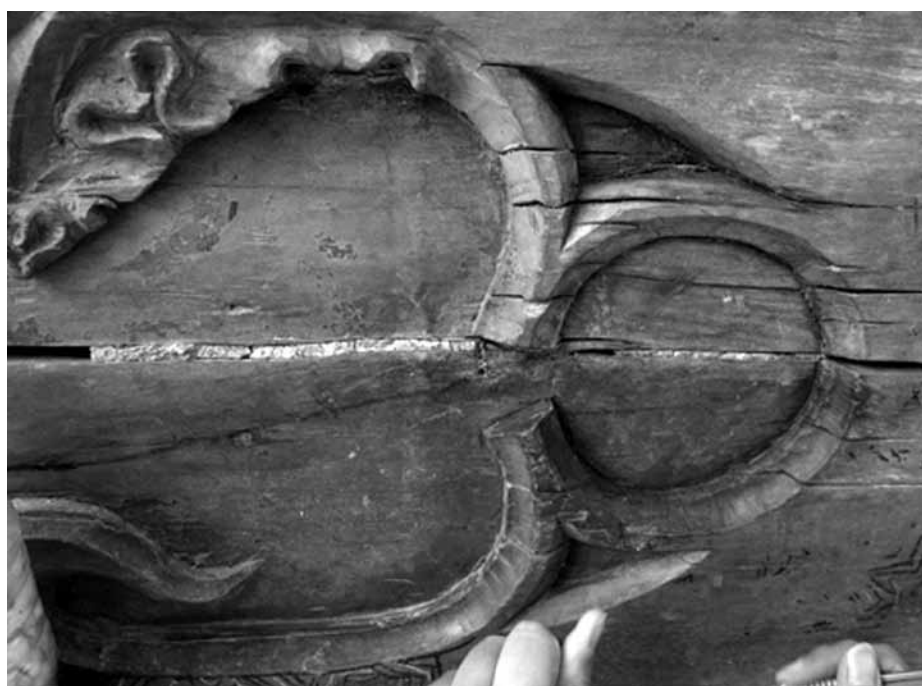
Lámina 6. Detalle de restauraciones antiguas.
