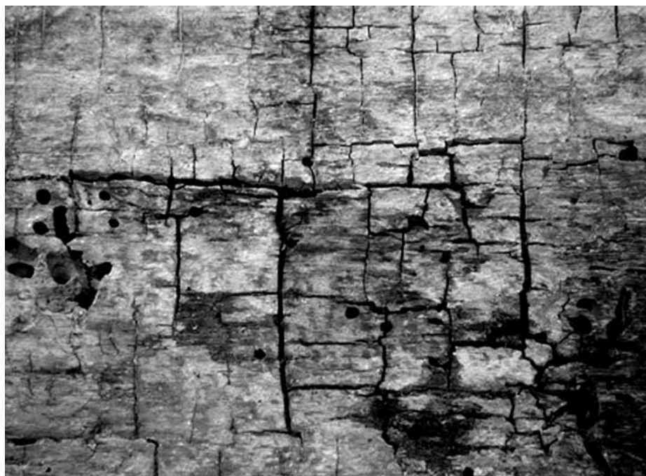
Lámina 5. Detalle de pudrición de la madera.
