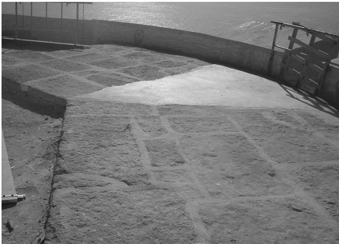
Lámina 5. Asientos para la artillería a barbeta en la terraza del Fuerte de San Juan. Fase de restauración.
