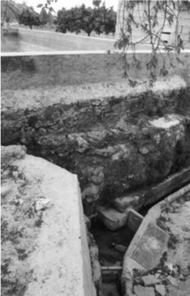
Lámina 9. Salida de agua de la balsa a riego abierto (sector 1, toma 1).
