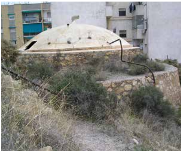
Lámina 4. Vista de uno de los aljibes que pudo haberse salvado de la demolición. Su construcción no era de gran calidad, pero con algunas obras de reparación y acondicionamiento de pequeño coste se habrían aprovechado para alguna actividad relacionada con la Universidad.
