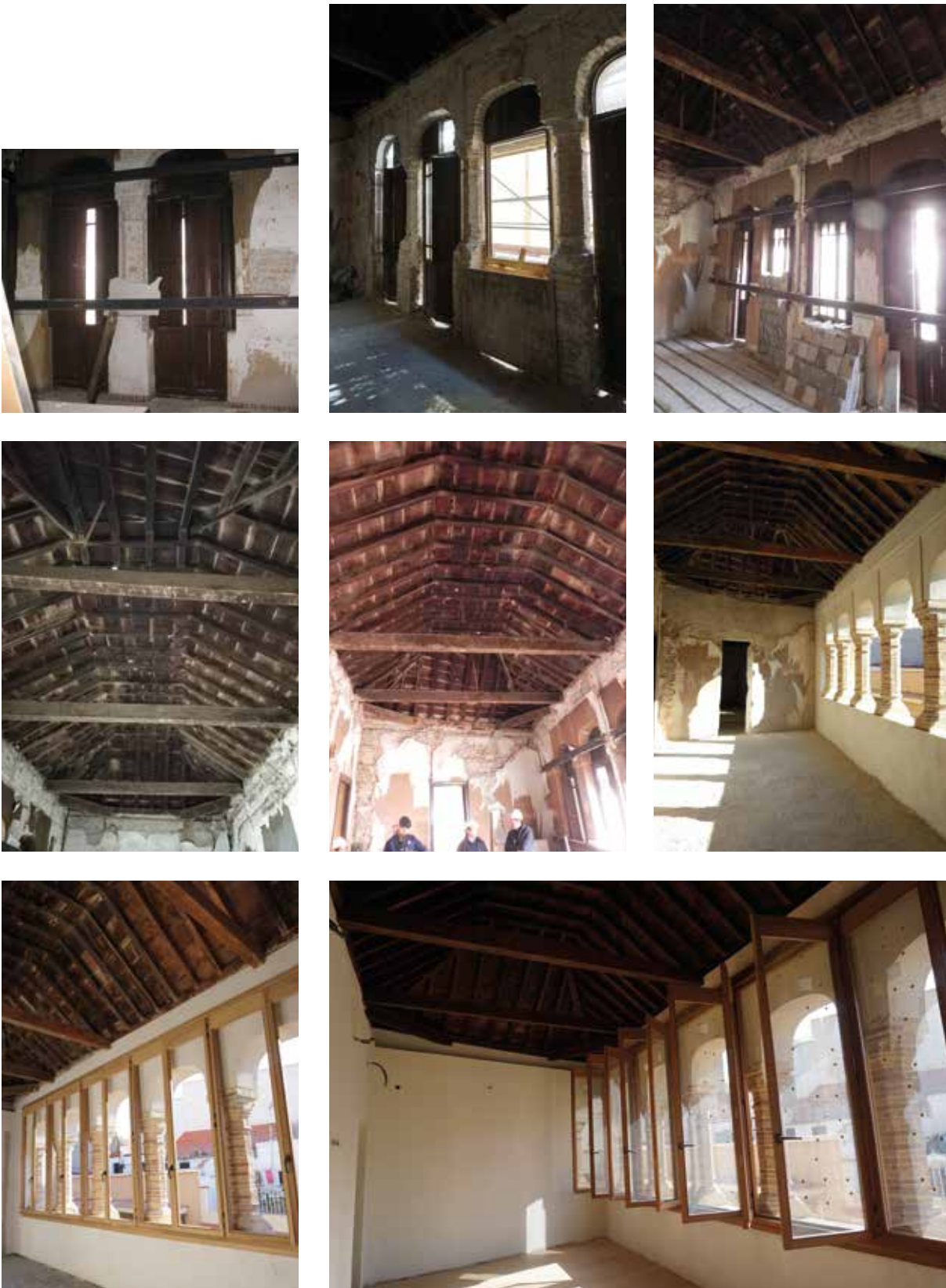
Lámina 12. Secuencia con los diferentes momentos de la ejecución de los trabajos en el mirador, desde la retirada de la balconada, hasta la recuperación de la armadura de cubierta, pasando por la limpieza y restauración de la arquería que conforma la loggia . Se han podido mantener íntegramente las pilastras de ladrillo tallado, así como los arcos, siendo necesario reponer los antepechos.
