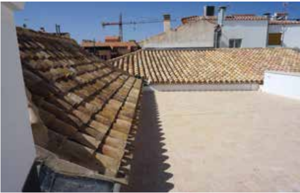
Lámina 19. Arriba, estado general de las cubiertas antes de las obras. A la izquierda se aprecia el volumen de la artesa que cubre la loggia , aunque muy deformada y con enormes desplazamientos de los aleros y la cumbre. Debajo, la misma vista de las cubiertas, una vez finalizados los trabajos, dejando completamente exenta la cubierta del mirador -izquierda- (se mantienen los escudetes en los dos testeros), así como la de la sala oeste que sustituye las chapas metálicas -de frente- y la nueva terraza que se sitúa sobre los pisos de forjados a base de las dos grandes vigas de madera y viguetas transversales, también de madera (esta terraza se ha solado con ladrillo cerámico manual y recoge gran parte de las aguas de la finca, canalizándolas a las bajantes por el patio trasero).
