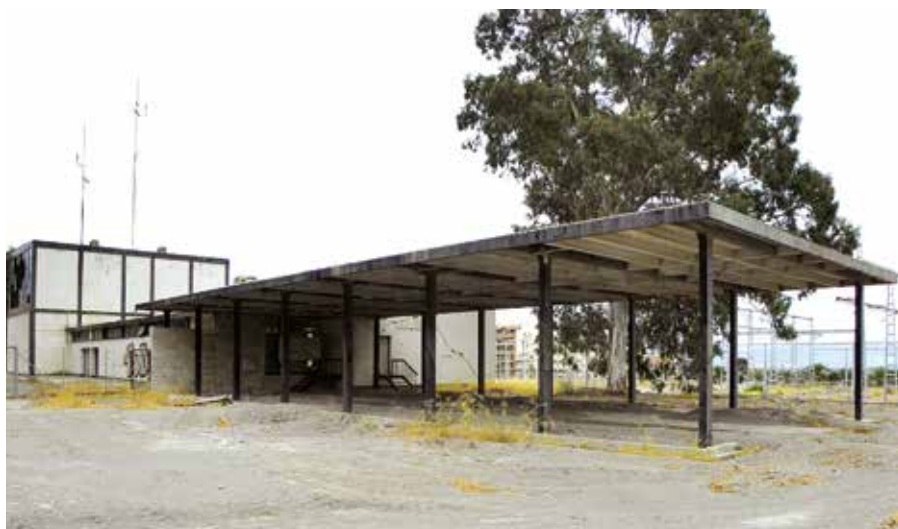
Lámina 10. Subestación eléctrica de Lorca. Celdas a la intemperie. Fotografía de J. Granados (agosto de 2017).
