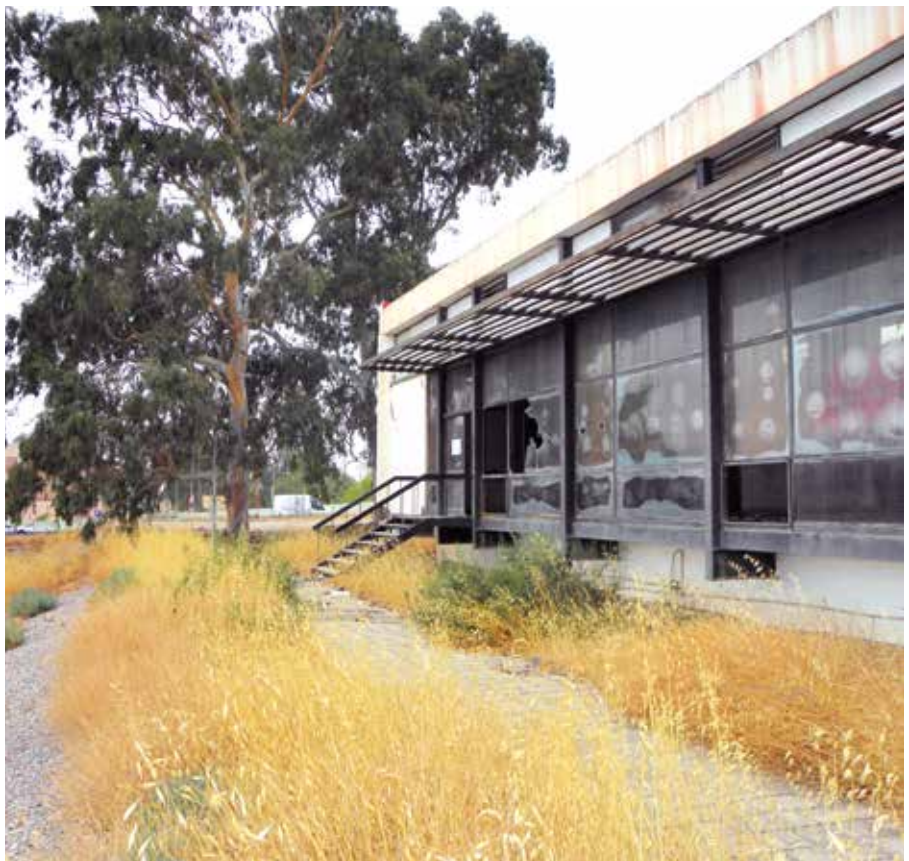
Lámina 6. Subestación eléctrica de Lorca. Edificio de mandos. Fotografía de J. Granados (agosto de 2017).
