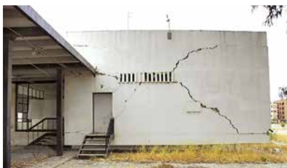
Lámina 11. Subestación eléctrica de Lorca. Botiquín. Fotografía de J. Granados (agosto de 2017).
