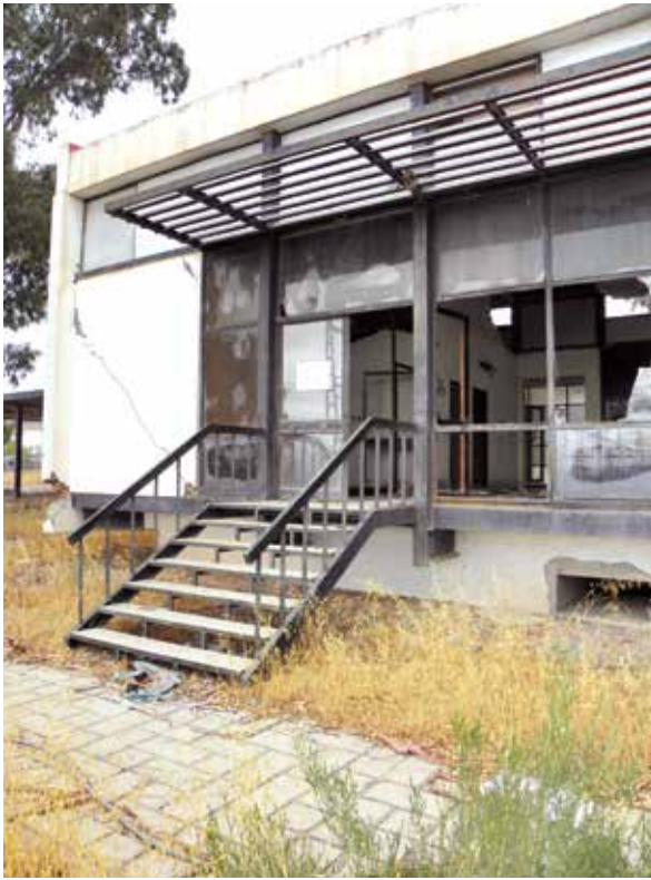
Lámina 15. Subestación eléctrica de Lorca. Detalle de escalera y parasol de la sala de mandos. Fotografía de J. Granados (agosto de 2017).
