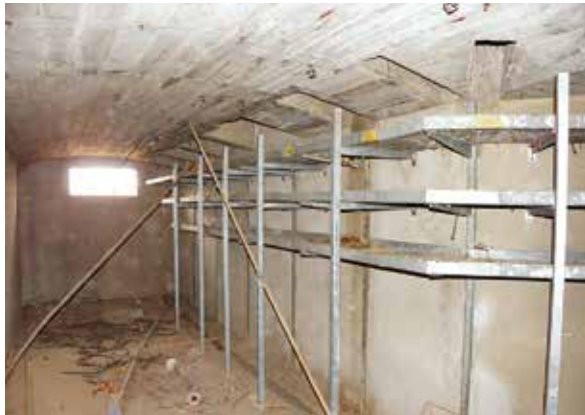
Lámina 4. Subestación eléctrica de Lorca. Galería subterránea. Fotografía de J. Granados (agosto de 2017).
