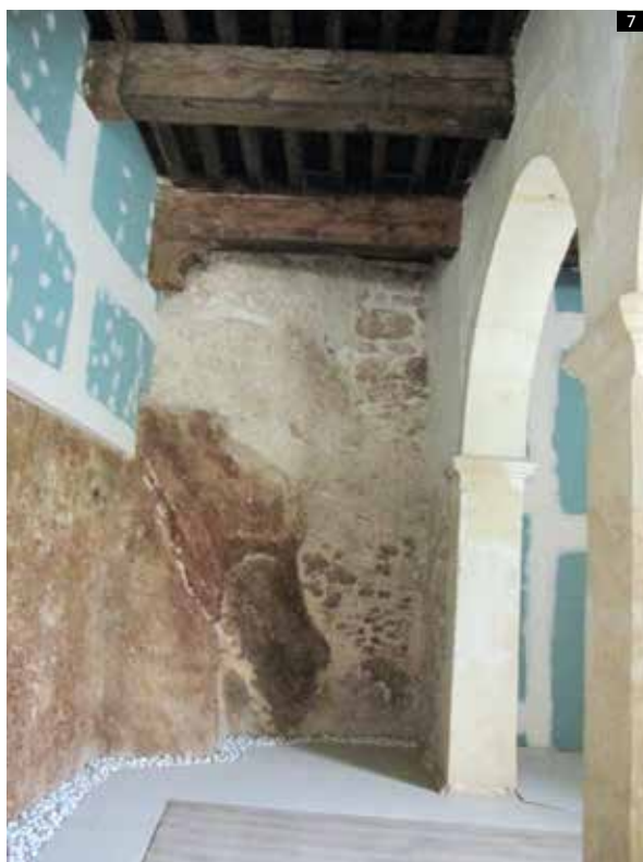
Lámina 7. Roca recortada en la planta baja del Pósito, lateral oriental. Fotografía: Ana Pujante.
