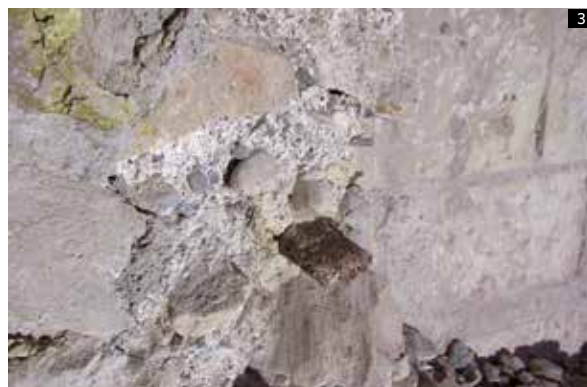
Lámina 2. Aguja de madera de uno de los mechinales de la torre del Reloj. Tramo planta 1. Fotografía: Ana Pujante.
