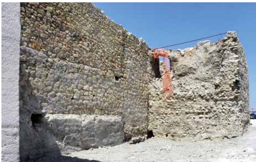
Lámina 3. Torre 5 y cortina adyacente. Estado anterior a la intervención. Fotografía: J. Granados.
