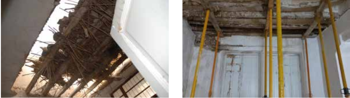
Lámina 7b. Apeos y forjados hundidos un año antes del terremoto.
