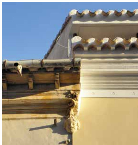
Lámina 6. Casa de los Quiñonero, Lorca. Fachada principal, extremo derecho de la cornisa. Fotografía: J. Granados, marzo 2014.
