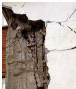
Lámina 1. “Daños estructurales” en la cabeza de un pilar de esquina situado en la planta baja. Desestructuración resistente del nudo: viga-pilar (disloque) que afecta a sus condiciones de estabilidad. Hormigones fabricados in situ que podrían no alcanzar las prestaciones supuestas. Probable separación excesiva de los estribos. (Detalle editado por el autor, utilizando una fotografía facilitada por la dirección del IES).
