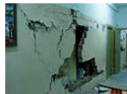
Lámina 2. “Daños constructivos” en un tabicón del pasillo de la planta baja del IES. Pared que discurre paralela al sentido longitudinal del edificio. Junto a las características grietas en cruz causadas por fuerzas de sentido contrario pero actuando en el mismo plano del tabique, se aprecia que las porciones de tabique resultantes están en diferente plano (en resalto o escantillón); posición que indica que también fue sometido a fuerzas perpendiculares al mismo. (Detalle editado por el autor, utilizando una fotografía facilitada en la Consejería de Educación).
