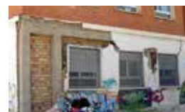
Lámina 3. “Daños constructivos” por desprendimiento de una de las hojas del cerramiento de fachada. La hoja exterior de la “Capuchina” se derrumba por falta de anclaje tanto a la estructura portante, como entre las dos fábricas que la forman (ausencia de llaves). (Detalle editado por el autor, utilizando una fotografía facilitada por la dirección del IES).
