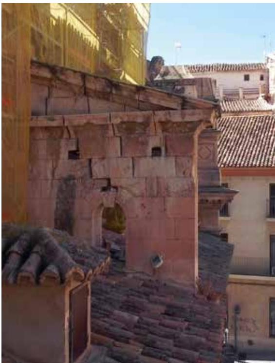
Lámina 2. Fotografía de uno de los contrafuertes de la nave inferior del lado del Evangelio, donde se aprecia la rotura de la clave de su arco y la continuación de la grieta más o menos a 45 grados.
