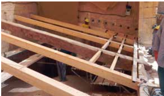
Lámina 3. Faldón sobre uno de los tramos de la nave lateral de la Epístola en su estado previo a las obras (arriba), con la estructura metálica, bardo y capa de compresión superior. En la fotografía inferior, los trabajos en dicho faldón una vez retiradas las estructuras rígidas, procediéndose a la colocación del entramado de madera, manteniendo la magnífica viga central.
