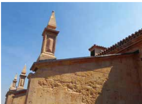
Lámina 5. Pináculos sobre los contrafuertes del lateral del Evangelio, en su estado tras los sismos (arriba) y en la actualidad (abajo).
