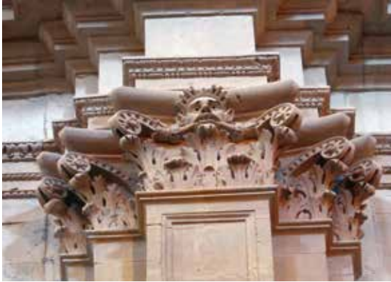
Lámina 7. Fotografía de uno de los capiteles de la nave central, una vez limpio de las múltiples capas de cal y pintura que lo deformaban.
