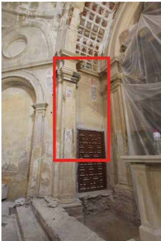
Lámina 15. Fotografía del interior de la capilla de la Virgen del Alcázar, donde se aprecian las catas realizadas sobre los paramentos, molduras, capiteles y cornisas en las que se aprecian los restos de pintura con decoraciones principalmente vegetales, así como marmoleados en los elementos arquitectónicos. En la parte inferior se aprecia el nivel de suelo primitivo del altar de la capilla, así como las basas talladas de piedra, tanto de los arcos como de la parte inferior del retablo.
