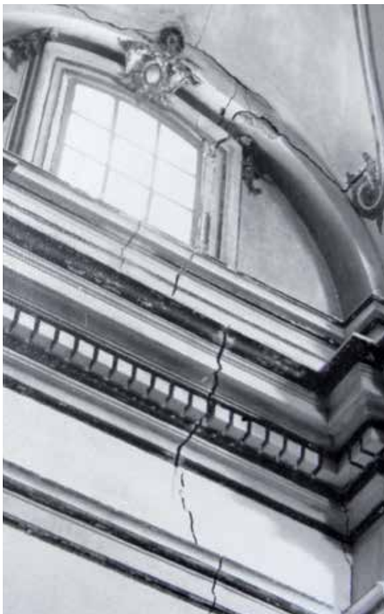
Lámina 11. Convento de Madre de Dios de Consolación, Lorca (Murcia). Grietas en los muros. Fotografía de Pedro A. San Martín Moro, 1965. AGIPCE.
