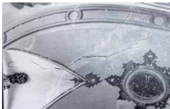
Lámina 9. Convento de Madre de Dios de Consolación, Lorca (Murcia). Grietas en las bóvedas. Fotografía de Pedro A. San Martín Moro, 1965. AGIPCE.
