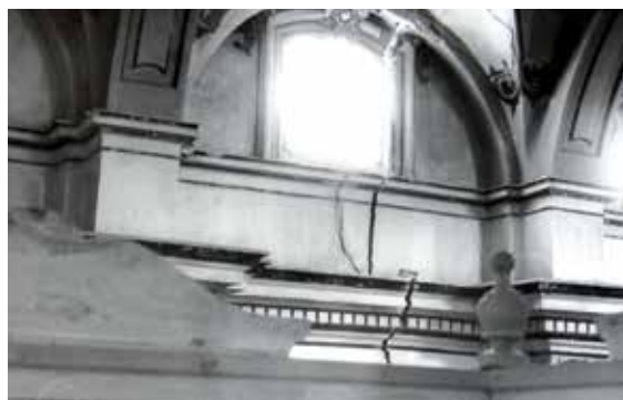
Lámina 10. Convento de Madre de Dios de Consolación, Lorca (Murcia). Grietas en los muros y lunetos. Fotografía de Pedro A. San Martín Moro, 1965. AGIPCE.
