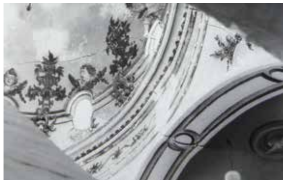
Lámina 8. Convento de Madre de Dios de Consolación, Lorca (Murcia). Grietas en la cúpula. Fotografía de Pedro A. San Martín Moro, 1965. AGIPCE.
