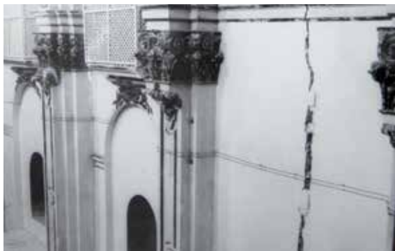
Lámina 14. Convento de Madre de Dios de Consolación, Lorca (Murcia). Muros laterales de la iglesia. Fotografía de Pedro A. San Martín Moro, 1965. AGIPCE.
