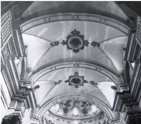
Lámina 25. Convento de Madre de Dios de Consolación, Lorca (Murcia). Bóveda. Fotografía de Pedro A. San Martín Moro, 1965. AGIPCE.
