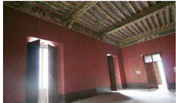
Lámina 12. Casa de Guevara. Daños en el salón principal, con grietas y fisuras en los cerramientos y desprendimiento de revestimientos.
