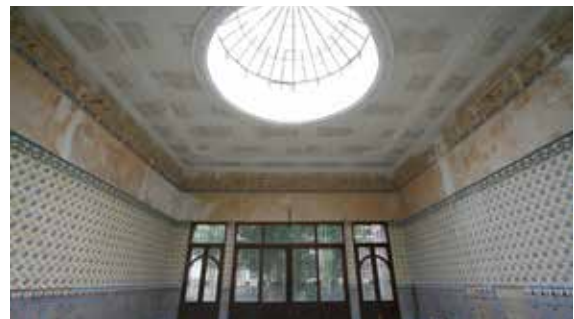
Lámina 13. Palacio de los condes de San Julián. Daños en el salón de baile, con grietas y fisuras en los paramentos verticales y techo, así como desprendimiento de alicatados.
