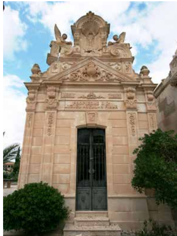
Lámina 17. Panteón de la familia Abellán. Grietas en fachada y giro, y desplazamiento de las esculturas de remate.
