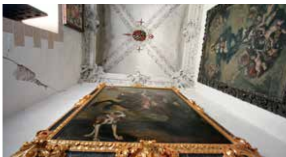
Lámina 10. Palacio Guevara. Grietas inclinadas en muros de carga de la escalera principal.
