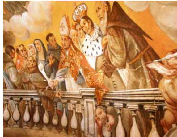
Lámina 6. Iglesia Virgen de las Huertas. Fractura horizontal de la cúpula de dos roscas con pérdida de las pinturas murales en la zona fracturada.
