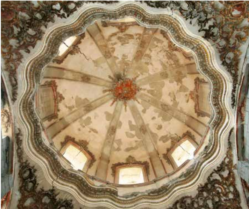
Lámina 4. Iglesia de San Juan. Grietas verticales en la cúpula que parten el dintel del vano y la cornisa ondulada, así como la zona superior de dos de las pechinas.
