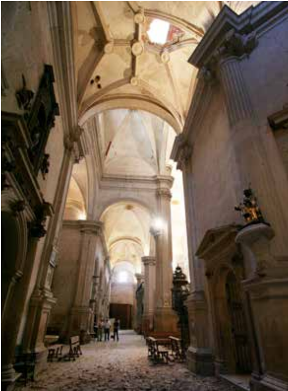
Lámina 5. Colegiata de San Patricio. Rotura de la plementería de las bóvedas del primer tramo de la girola producido por el vuelco de cinco de los florones del remate de la torre.
