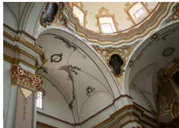
Lámina 9. Iglesia del Carmen. Fractura de los arcos del crucero.
