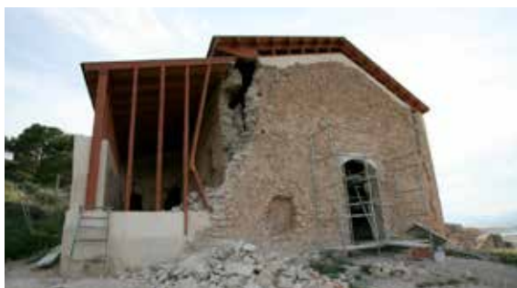
Lámina 2. Ermita de San Clemente. Daños en los cerramientos, con fuerte agrietamiento de la esquina norte y desplome de fábricas.
