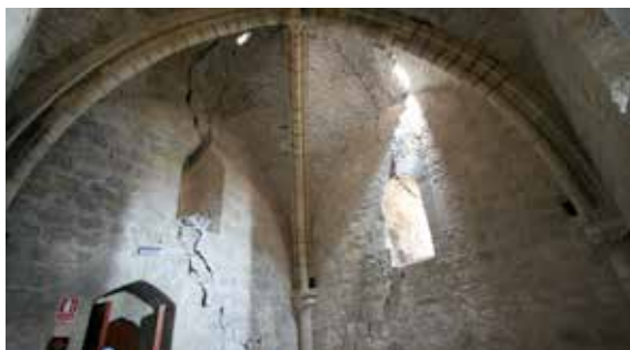
Lámina 1. Torre del Espolón. Desplazamiento de los muros interiores del primer cuerpo de la torre, con grietas en diagonal y separación del fuste respecto de la basa en la columna de esquina.
