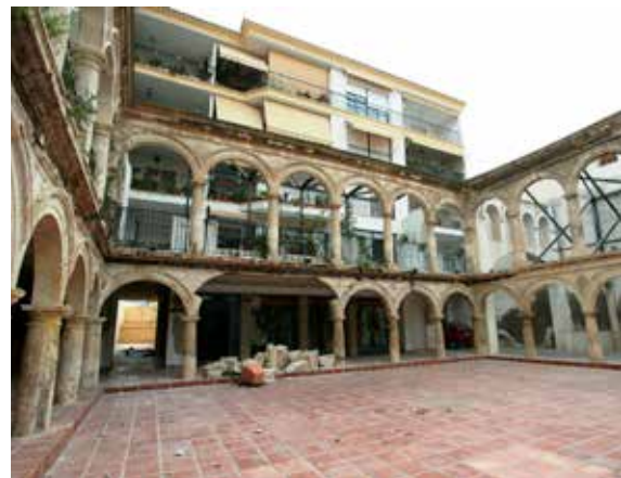
Lámina 7. Claustro del convento de Santo Domingo. Fractura de fuste de columna y colapso parcial de arquería del cuerpo inferior.
