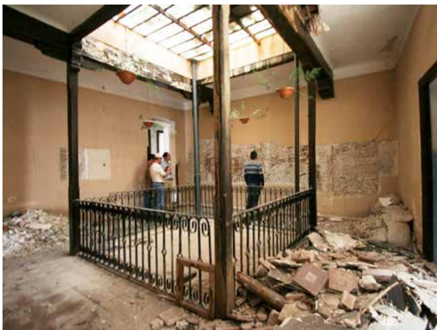
Lámina 11. Casa de los Irurita. Daños en los cerramientos del patio y colapso parcial de forjados.
