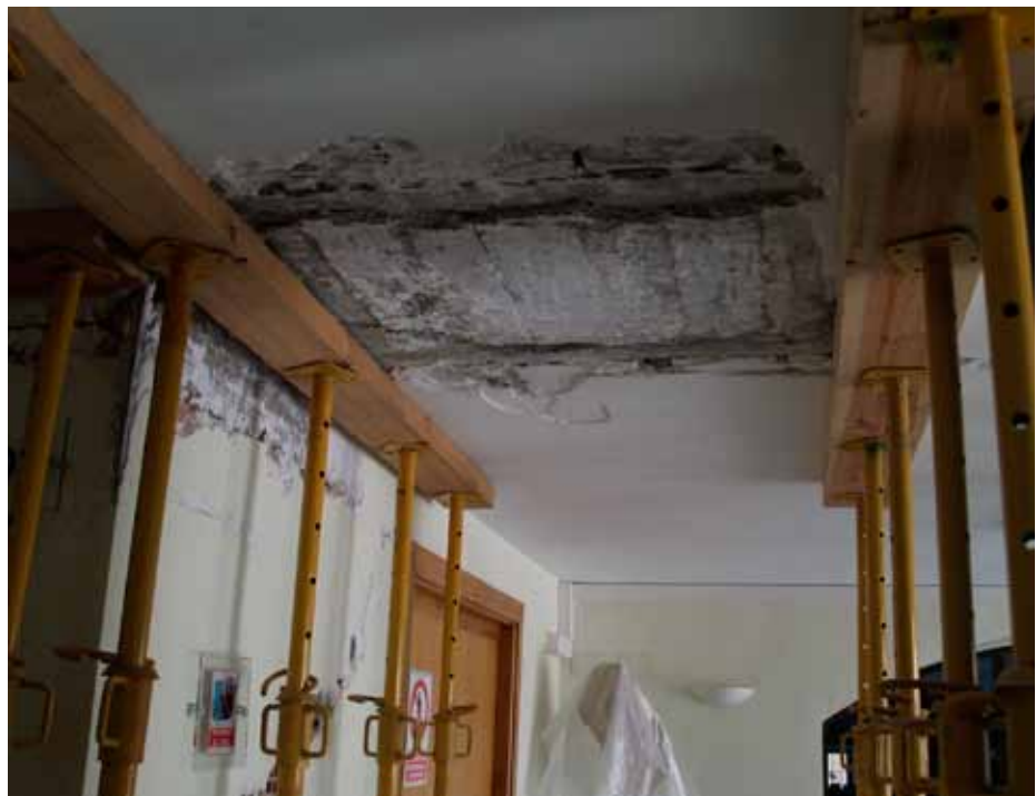
Lámina 2. Daños en la junta estructural entre las dos zonas del Museo Arqueológico Municipal de Lorca.
