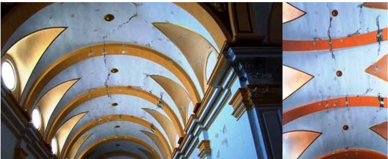
Lámina 2. Agrietamiento en arcos y bóveda de la nave central.
