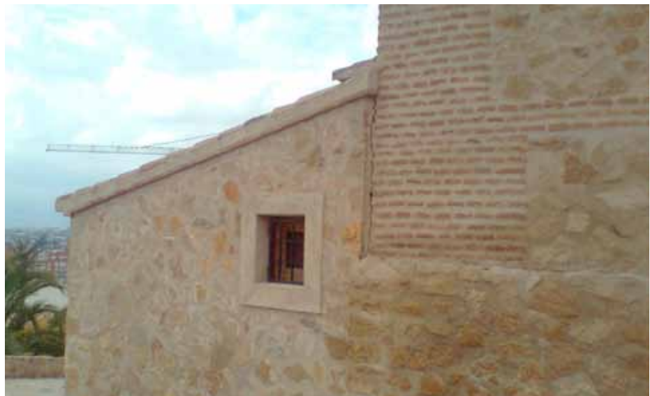
Lámina 2. Presencia de grietas en la unión de fábricas de mampostería y en la unión de fábricas de mampostería con fábricas de ladrillo. Estos daños no presentaban gravedad y su reparación, atendiendo a la altura y volumetría de estas capillas no presentaba ninguna dificultad.
