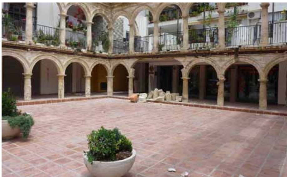
Lámina 3. Aspecto general del claustro tras los terremotos.
