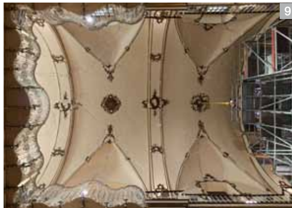
Lámina 9. Panorámica del estado de la bóveda de la nave.
