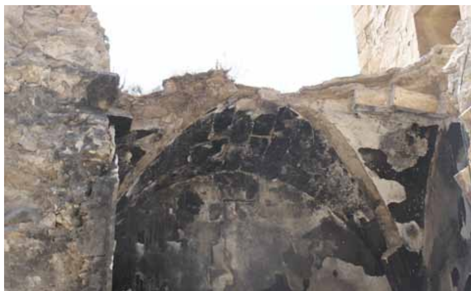
Lámina 6. Bóveda de vestíbulo de ingreso a la iglesia parcialmente derruida en más de un 50%. Imagen tomada el 24 de mayo de 2011.
