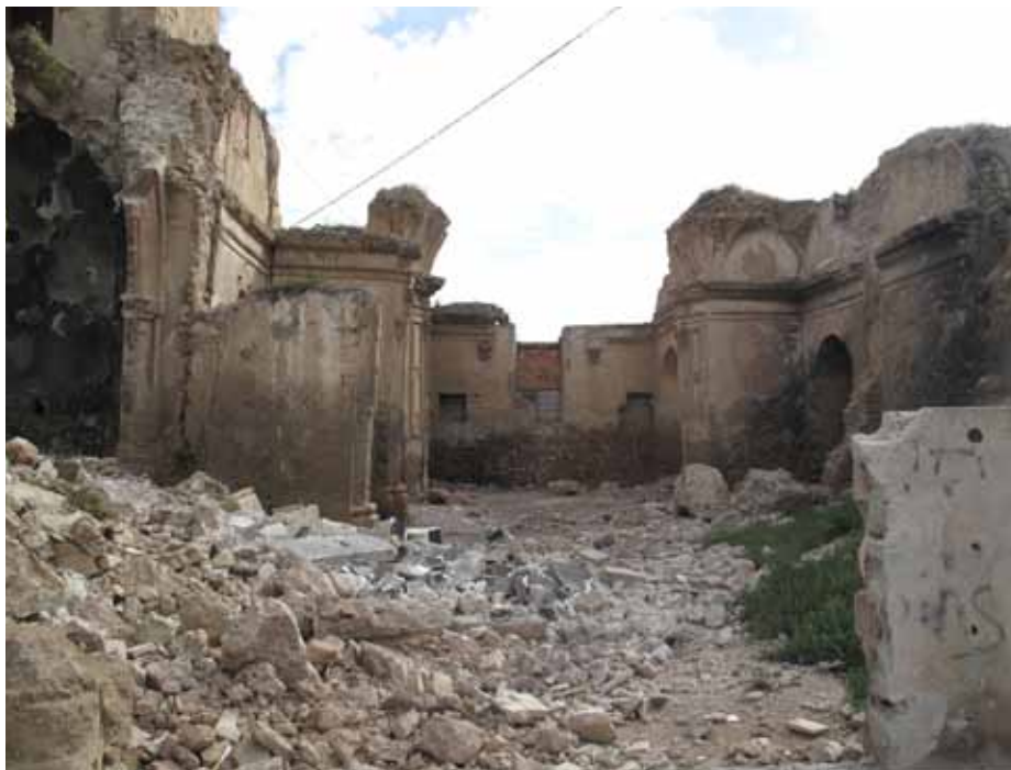
Lámina 7. Situación de la iglesia unos días después del terremoto. Los escombros del suelo pertenecen a la única bóveda original que permanecía hasta nuestros días. Imagen tomada el 24 de mayo de 2011.
