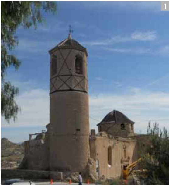
Lámina 2. Inicio de los trabajos de zunchado y refuerzo en la torre campanario. Se aprecian grietas verticales e inclinadas en sus fábricas, y la apertura en su cuerpo superior, con pérdida de claves de los arcos.
