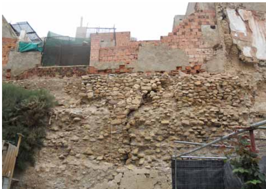
Lámina 8. Estado actual del lienzo de muralla C-27, donde puede apreciarse su avanzado estado de deterioro, agravado por las construcciones construidas sobre la muralla.
