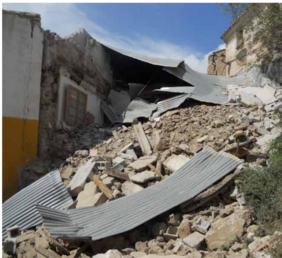
Lámina 4. Torreón 9. Estado del lugar que ocupaba la torre T-9 en mayo 2011. Esta torre previamente había sufrido varios derrumbes, el último en el año 2007, del que prácticamente apenas se conservaban restos de las fábricas.
